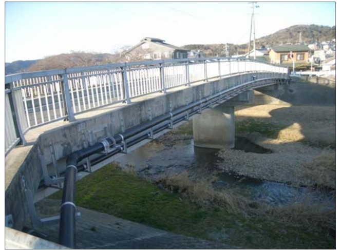
水管橋 (アラミド外装PE管 φ150)
