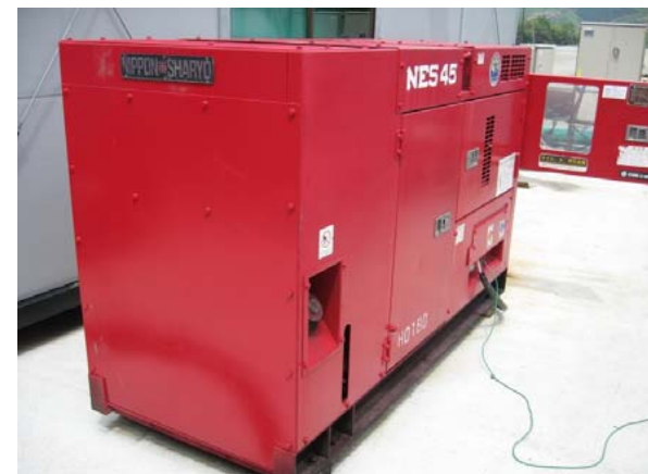
エンジン式発電機
